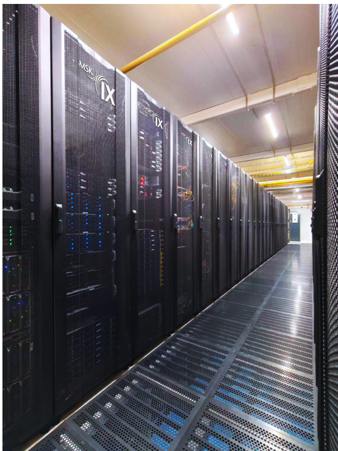
Фото 3. Узел точки обмена трафиком.
