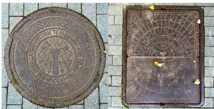
Рис. 17. основополагающие люки телефонной канализации — Москва, 1901-1917.
